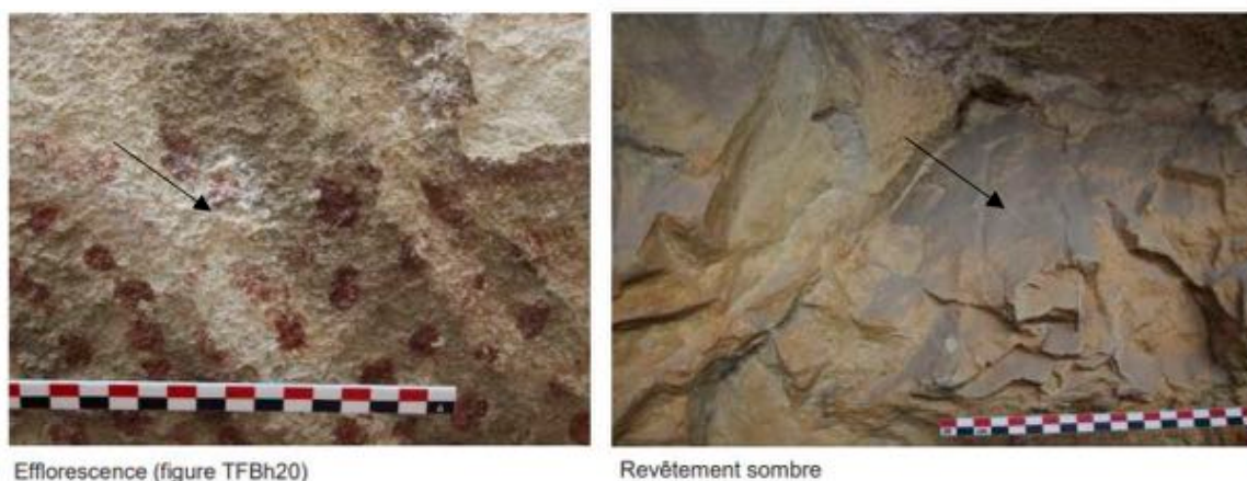
Figure III.19 : Exemples d'altérations biologiques et/ou chimiques observés au Trou de la Féclaz : a) efflorescence et b) revêtement sombre. Macrophoto M. Le Turnier.
